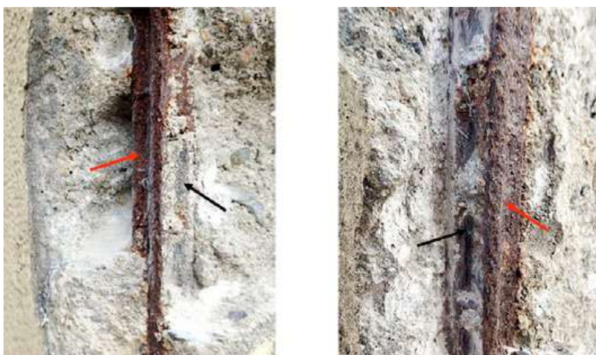
Obr. 5 Koroze výztuží závěsů
